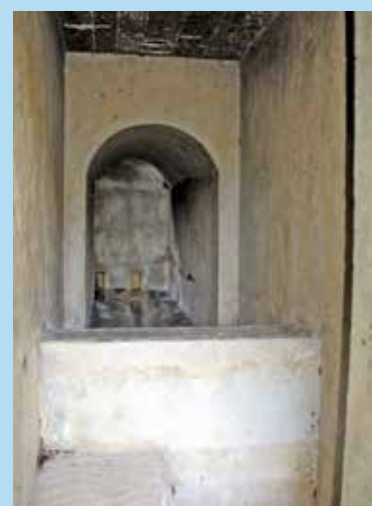
Captage de la source Constant (vue intérieure)
