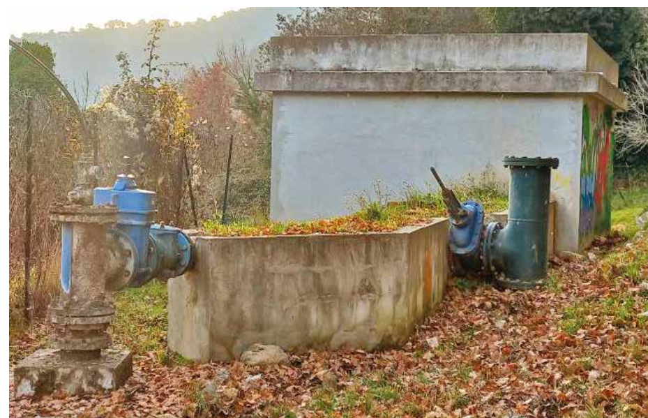
Les forages et la station de pompage de Cantaron
